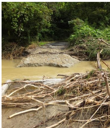
橋も落ち道路も寸断！
